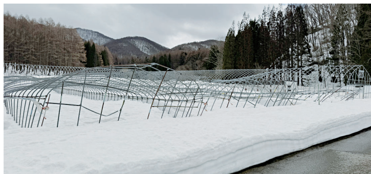
▲大雪により破損したパイプハウス
